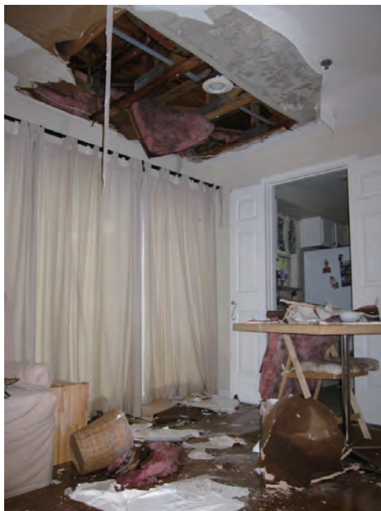
図3：上階からの漏水のため天井が抜けた我が家(2012年5月)。
