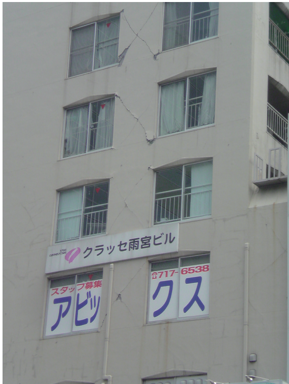
・ひびの入ったビル
